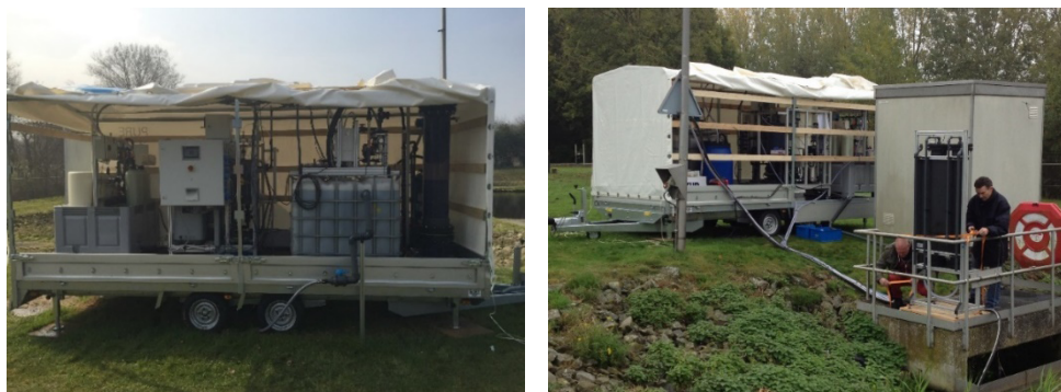
SFEERBEELDEN PILOT TESTEN BIJ RWZI PANHEEL. OPSTELLING TESTINSTALLATIE (LINKS). AANSLUITING OP DE RWZI (RECHTS)
