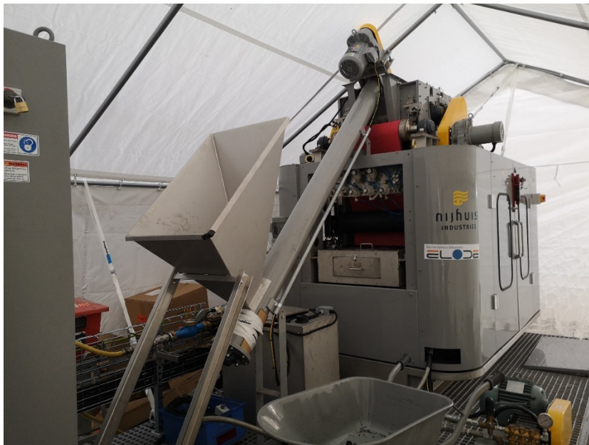
OPSTELLING NEO PILOT IN TENT OP RWZI NIEUWGRAAF
